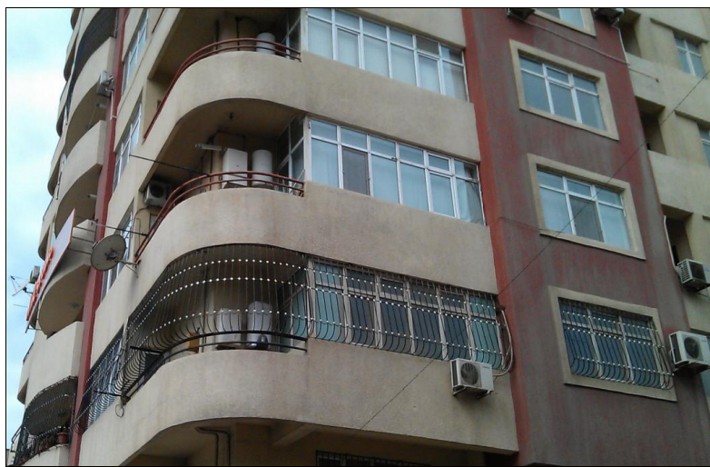
Рис. 17.1. Мини-котлы на балконе многоквартирного дома, обогревающие отдельные квартиры
