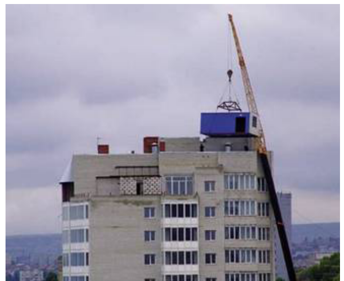
Рис. 13. Монтаж модульной котельной на крыше строящегося жилого дома (фото с сайта russkie.org).
